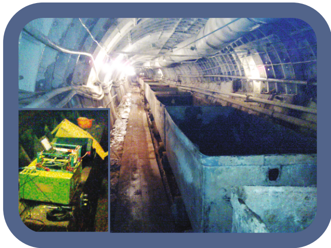
Перегонный туннель на станции метро Петровско-Разумовская. Слева показаны акселерометры и регистратор колебаний бетонной подушки рельсового пути
